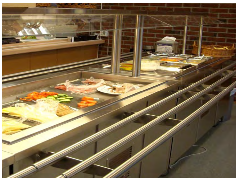
Kjølt brønn KBK, overhulle OHB, rørbrettbane
